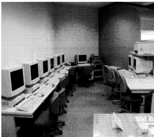
写真6 旧サーバが設置してあった場所
